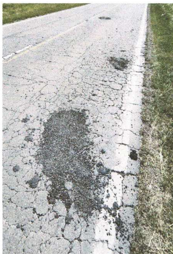
Figura 7. Bacheo mal ejecutado, desprendimiento de material y piel de cocodrilo
