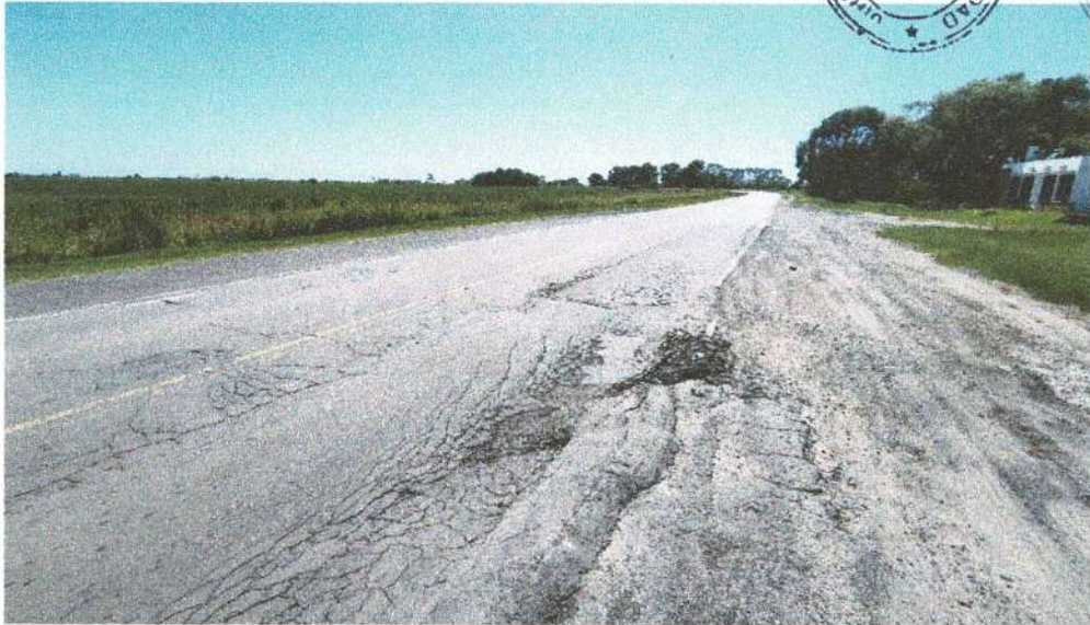
Figura 8. Deformación de la calzada, piel de cocodrilo y ahuellamiento
