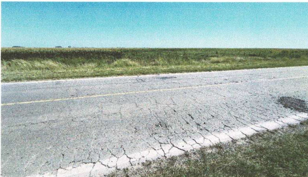
Figura 9. Piel de cocodrilo, desprendimientos y bacheos mal realizados
