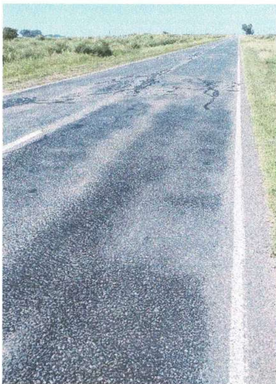
Figura 4. Exudación del asfalto
