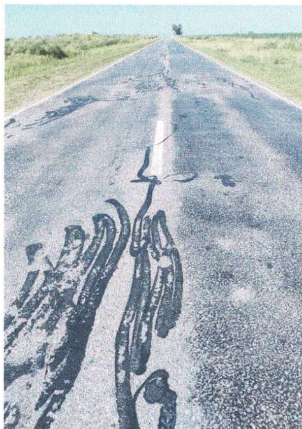
Figura 6. Sellado de fisuras y exudación
