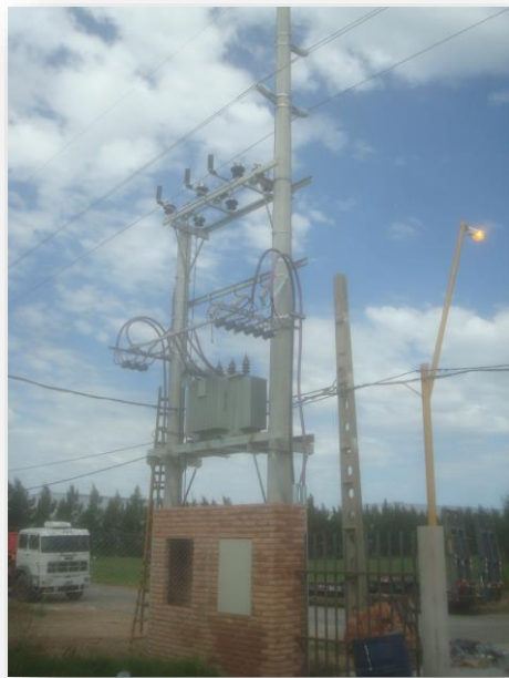
Acometida en Baja Tensión – 380 V
